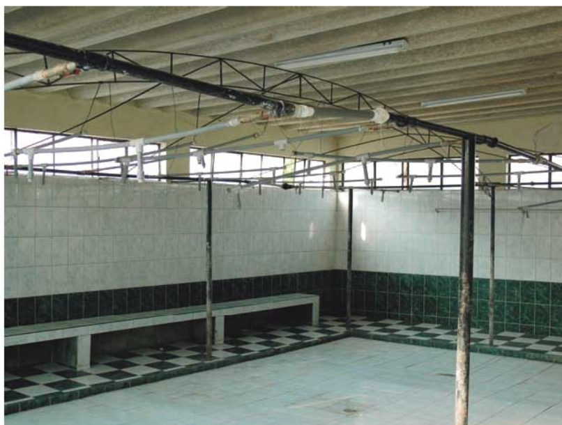
Duchas - ETS PNP de Puente Piedra
