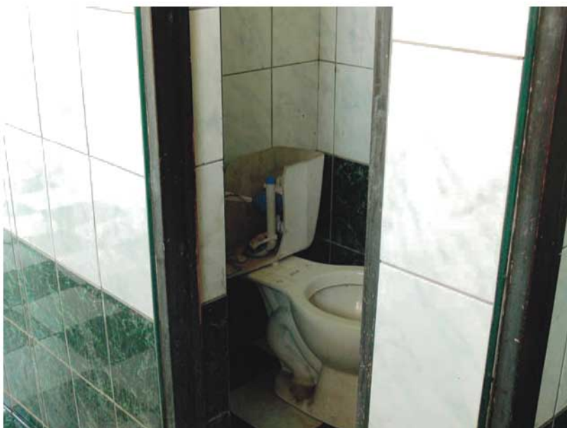
Baños – ETS PNP de Puente Piedra
